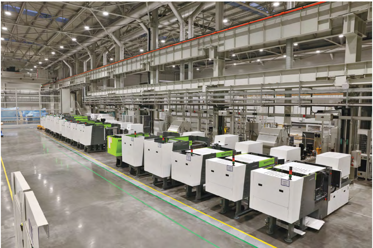
Συναρμολόγηση μηχανών έγχυσης WINTEC στην αίθουσα παραγωγής στο Changzhou
